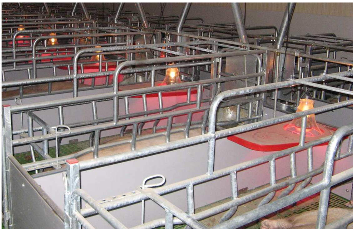
Instal·lació amb làmpades CS+
